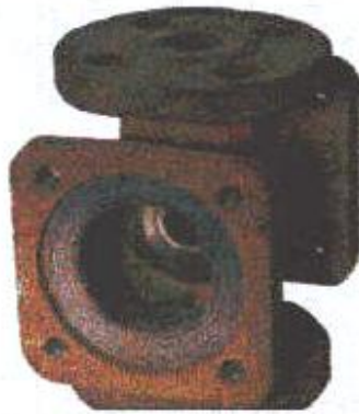
Fig. I.14: Corrosion générale (rouille) d'une pièce en acier
