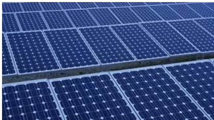
Figure 4 : Les panneaux solaires photovoltaïques [13].
