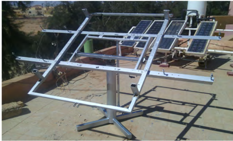
Figure V.3 porteur du capteur solaire
