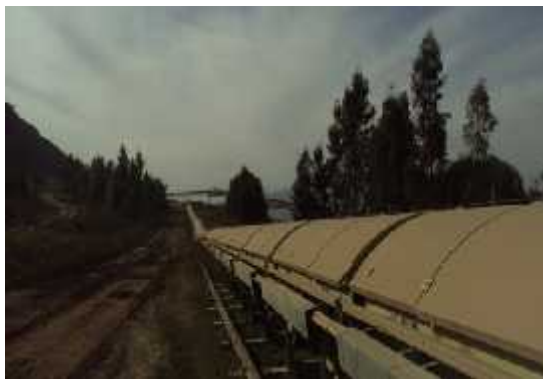
Photo IV.5 : Transporteurs mécaniques des matières premières vers l'usine (Source : Auteur, 2011)
