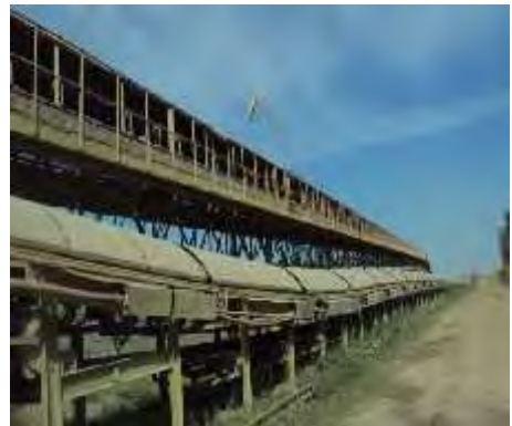
Photo V.4 : Transporteurs mécaniques et pneumatiques (Source : Auteur, 2011)
