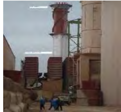
Photo V.2 : Nouvelle cheminée avec filtre à manche (Source : Auteur 2011)
