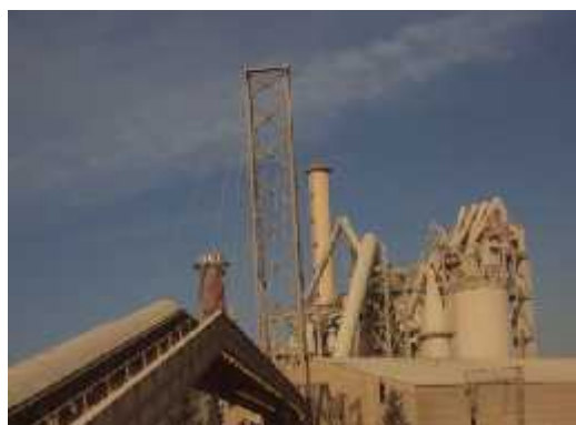
Photo IV.10: Nouvelle cheminée avec filtre à manche. (Source : Auteur 2011)
