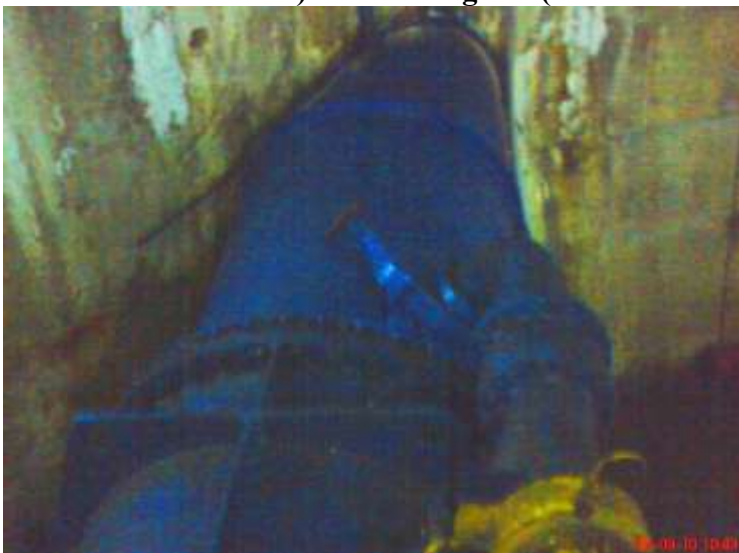
) Vanne de garde(
