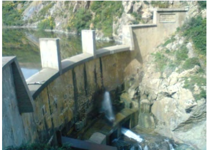
صورة رقم (15) حاجز سد شعبة الأخرة لإعادة تجميع المياه
