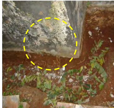
L'infiltration des eaux de pluies dans la partie sud de la mosquée provenant de l'espace tombal extérieur qu'il faut stopper à l'aide d'un drainage.
