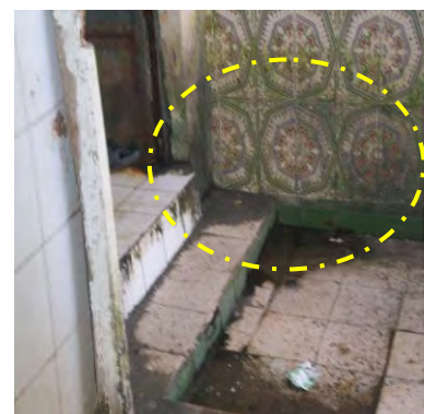
Détérioration des revêtements en faïence.
