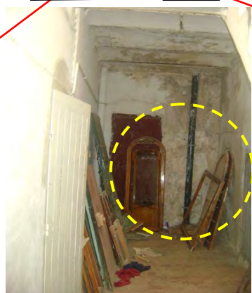
Les locaux en annexes présentent tous des traces d'humidité qui causent des décolllements des enduits intérieurs.
