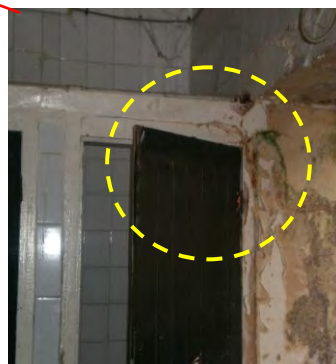
Une rénovation de cet espace est plus que nécessaire, en effet, il faudra reprendre l'installation de la plomberie et la réfection des maçonneries.
