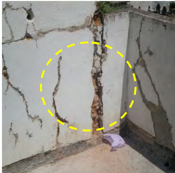
Plusieurs fissures existent sur le muret de la terrasse.
