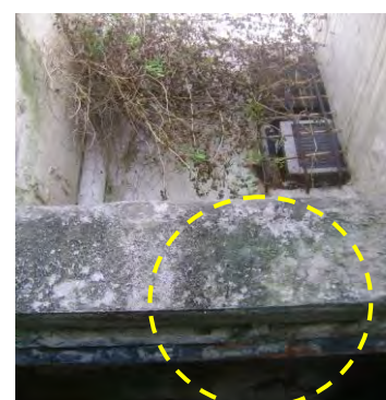
Détérioration des enduits extérieurs. Présence de végétation qui nous renseigne sur la présence d'eau due à une mauvaise étanchéité.
