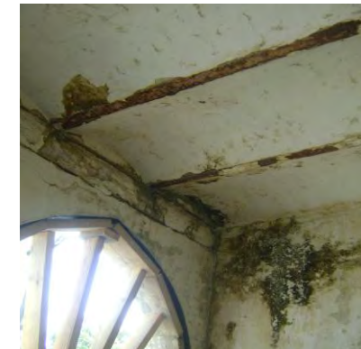
La couverture du portique de la cour est constituée plancher en voutains.
