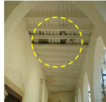
Le plancher à solives du portique d'entrée est détérioré.
