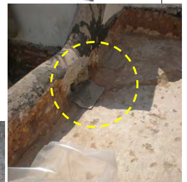
Les descentes des eaux de pluies sont défectueuses
