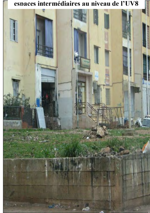
Photo 10 : L'état de dégradation des espaces intermédiaires au niveau de l'UV8
