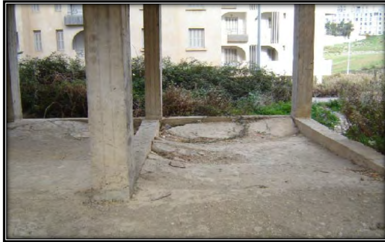
Photo 78 : Affaissement de la plate-forme du bloc5. Source : Auteur ; 2011.
