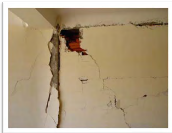
Photo 23 : Destruction de l'extrémité du panneau du fait de la compression de la diagonale qui se forme dans le mur. Source : Le risque sismique et le redéploiement des activités et de l'urbanisation Algérie 2020.
