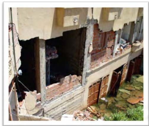
Photo 24 : Destruction des panneaux au RDC. Source : Le risque sismique et le redéploiement des activités et de l'urbanisation Algérie 2020.
