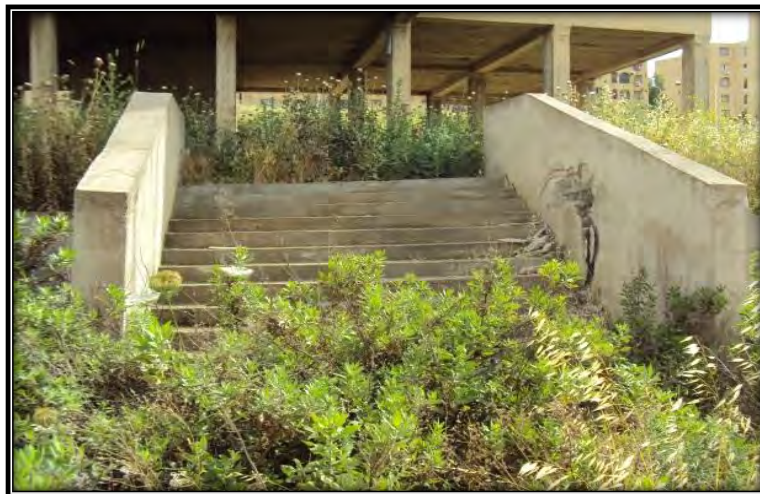
Photo 79 : Dégradation au niveau des escaliers Source : Auteur ; 2011.
