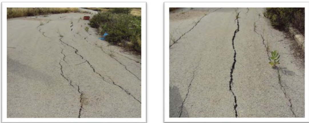
Photo 71 : Affaissement au niveau de la rue ; et montre le sens du glissement de terrain. Source : Auteur ; 2011
