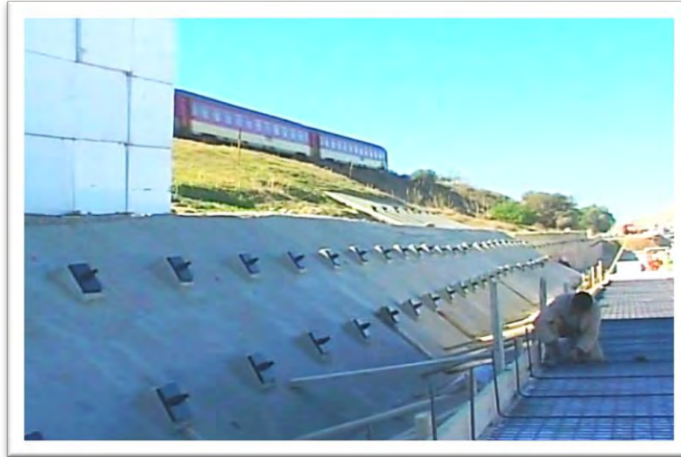
Photo 45 : Stabilité du glissement de terrain au niveau du PK de la RN6 liaison FES-TAZA.
