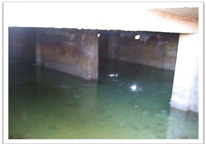
Photo 64 : Sous-sol de bâtiment constamment inondé, baignant dans la nappe superficielle des argiles décomprimées miocènes (zone A). Source : DUC.
