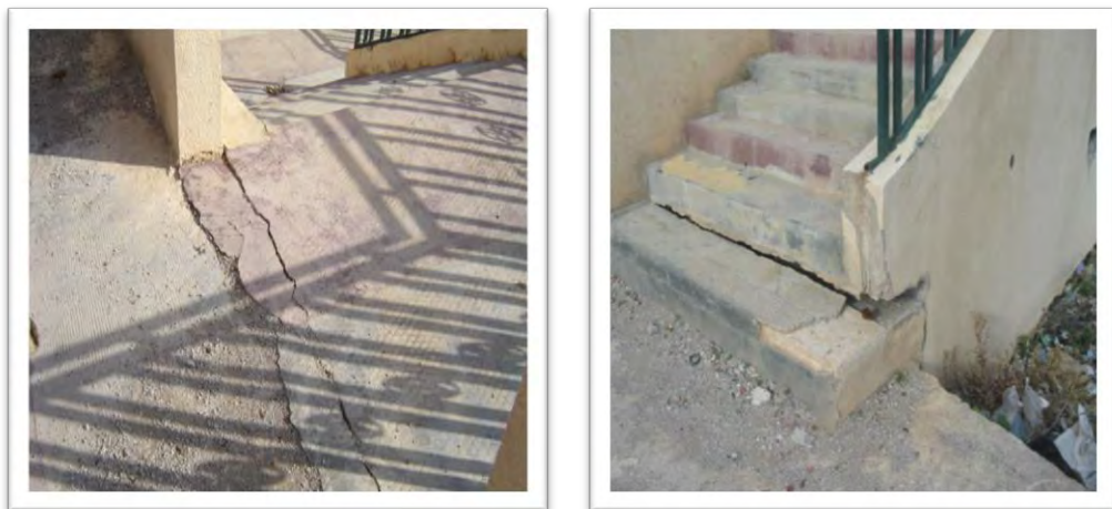
Photo 88 : Tassement des escaliers extérieurs. Source : Auteur ; 2011.
