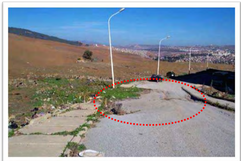
Photo 55 : Route déformée et fissurée à Bousouf. Source : DUC
