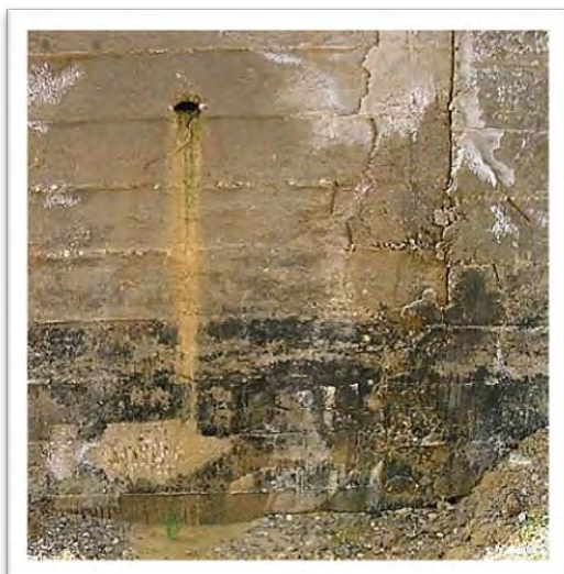
Photo 63 : Sortie de drain et suintement d'eau sur un mur de soutènement. Le massif filtrant derrière le mur n'a pas été réalisé. Source : DUC.
