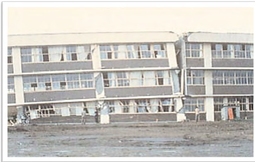
Photo 19 : Dommages dus à l'entrechoquement de deux blocs de bâtiment séparés par un joint de dilatation thermique (séisme de Tokachi-Oki, Japon, 16 mai 1968). Source: Milan ZACEK ; 2004.
