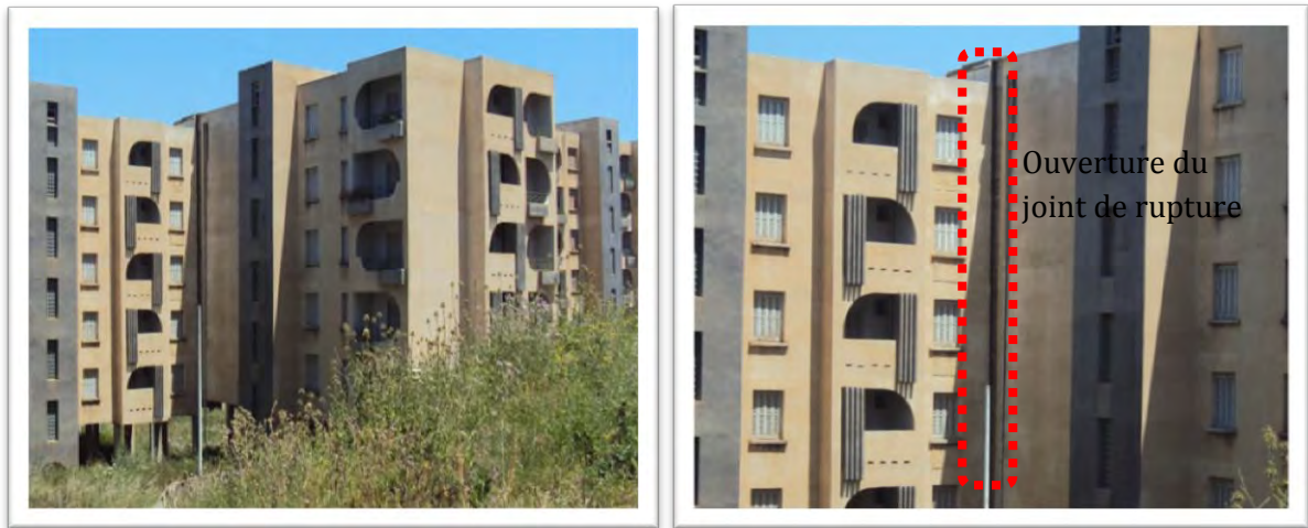
Photo 73 : Ecartement entre les deux blocs 4 et 5- ouverture du joint 60cm. Source : Auteur ; 2011.
