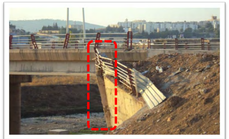
Photo 69: Dégradation au niveau du pont Rhumel. Source : Auteur, 2011.
