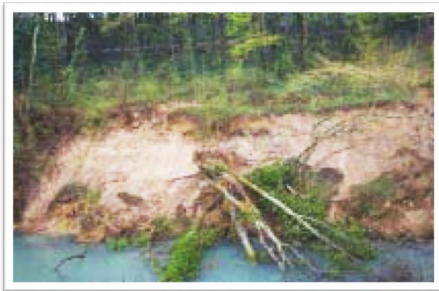
Photo 1 : Glissement superficiel le long des berges du Rhône. Source: www.sieng.ch
