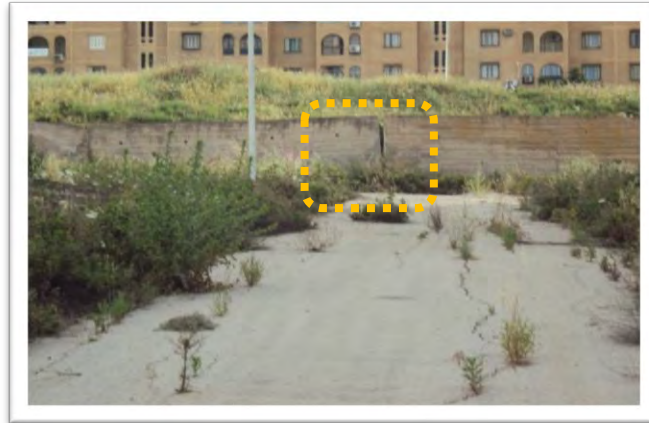
Photo 72 : le disjointement du mur de soutènement par le glissement du sol.
