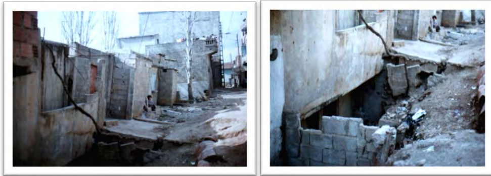
Photo 17 : Vue partielle d'un alignement de constructions ayant subi des basculements à Boudraa Salah. Source: POS cité el Bir ;2003.
