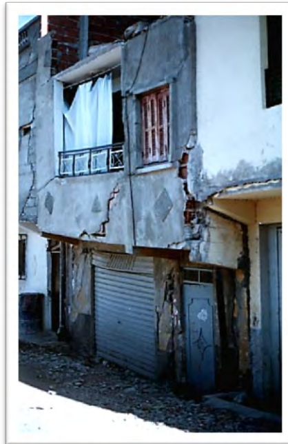
Photo 53 : Graves dégâts subis par une construction R+1 qui a été abandonnée par ses occupants, Site Boudrâa Salah. Source : POS ; 2003.
