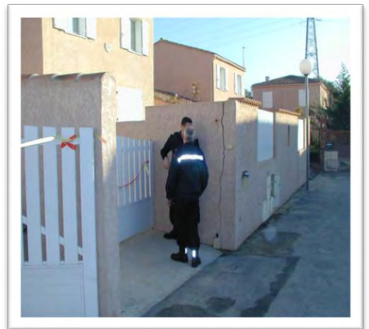
Photo 30 : Fissuration du mur (glissement de la Valantelle, à Marseille 2001) Source: www.brgm.fr
