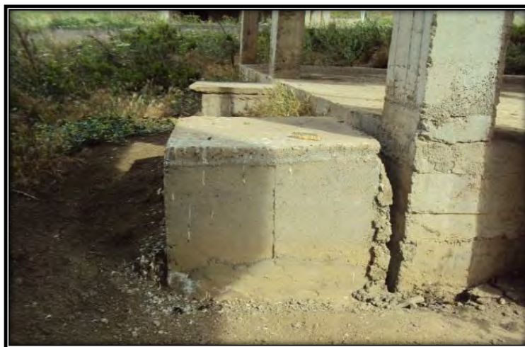
Photo 80 : Déplacement au niveau des regards Source : Auteur ; 2011.
