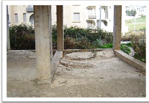
Photo 37: Affaissement de la plate-forme bloc 4 de la « cité CNEP » Boussouf. Source : CTC.2009
