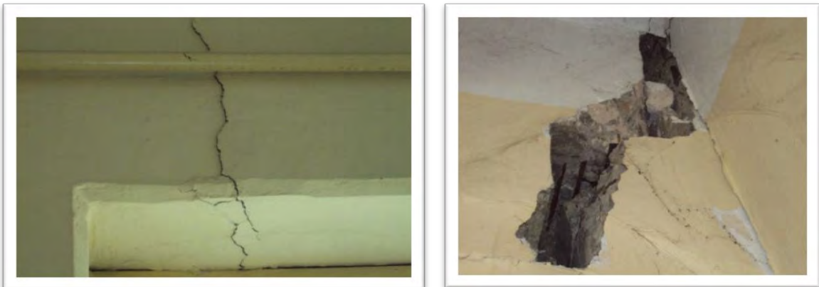
Photo 43 : Déplacement /éclatement/rupture des poutres et poteaux.
