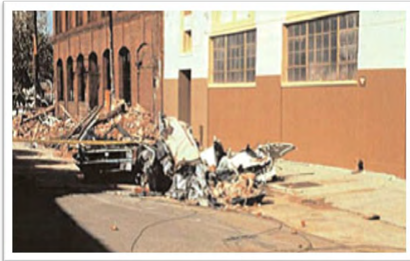
Photo 20 : La chute de briques de parement lors du séisme de Loma Prieta, Californie, 17 octobre 1989
