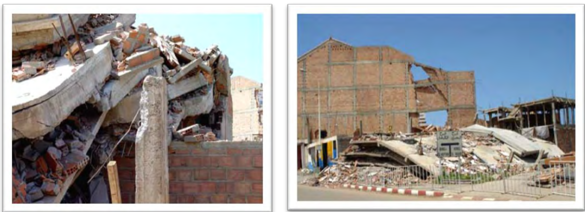
Photo 25 : Effondrement total par rapport au « point fixe » que constitue le bâtiment situé au fond. Source : Le risque sismique et le redéploiement des activités et de l'urbanisation Algérie 2020.
