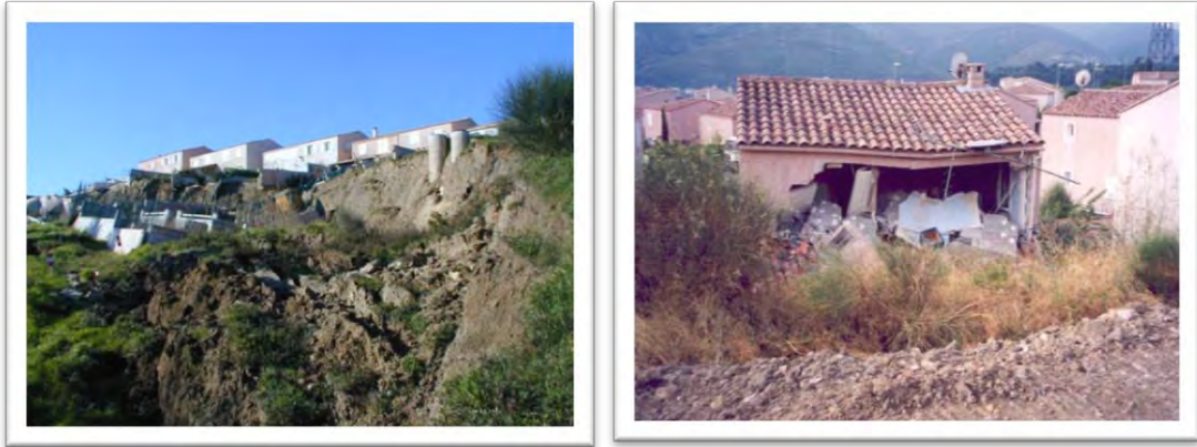
Photo 27 : Maison endommagée en pied de glissement de la Valantelle, à Marseille 2001. Source: www.brgm.fr
