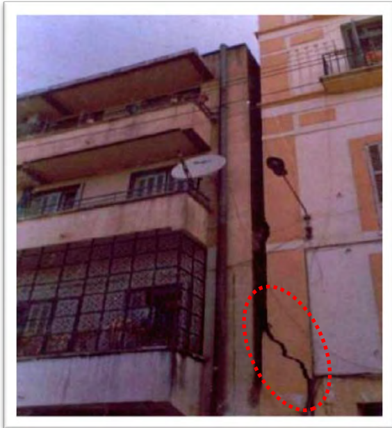
Photo 54 : Une façade fissurée d'un immeuble. Site Belouizded-kitouni. Source : Mezhoud Lamia, 2005.
