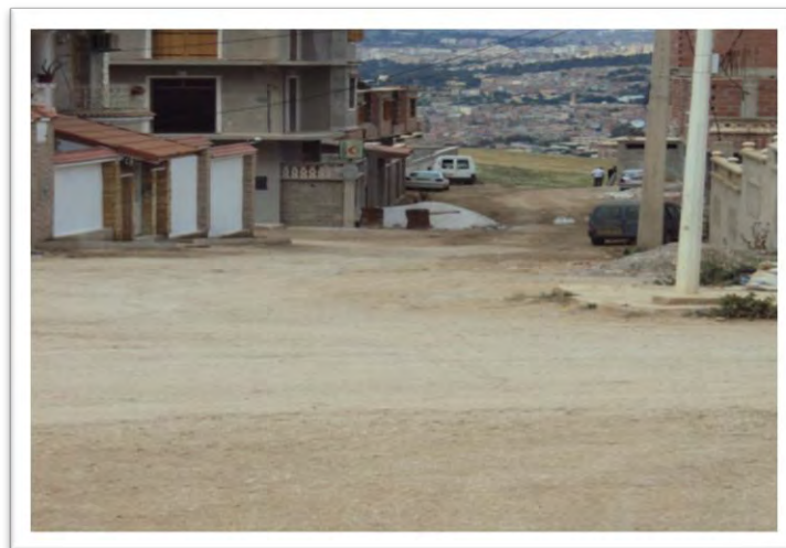
Photo 90 : Affaissement de la rue et les revêtements des trottoirs. Source : Auteur ; 2011.
