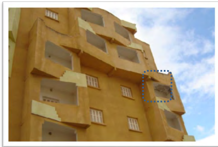
Photo 85 : Le cloquage de peinture. Source : Auteur ; 2011.
