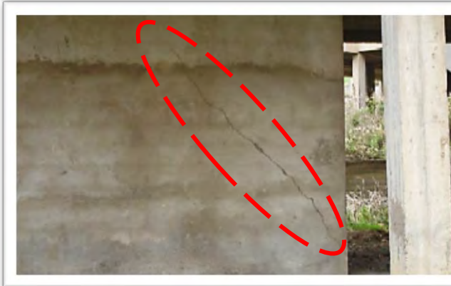
Photo 32 : Fissure dans le mur de la cage d'escalier « cité CNEP » à Boussouf. Source: auteur 2011.
