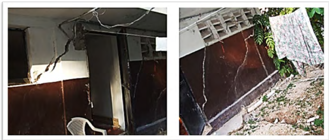
Photo 39 : Les fissurations aux niveaux des ouvertures (le glissement de l'impasse Avalon). Source: Bureau des mines et de l'énergie direction de la géologie et des mines service des mines ; 2008.
