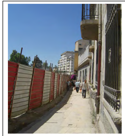
Photo N°26 : Les trottoirs sont trop petit et en mauvais état.
