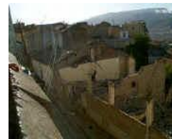
Conséquence des glissements de terrains
