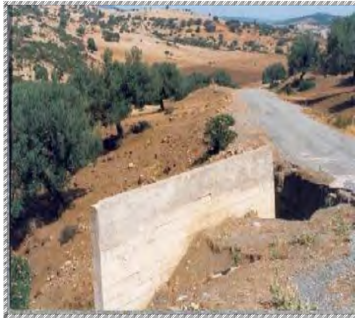
صورة رقم: 18 انعكاسات التعرية على مستوى المنشآت القاعدية حيث أدت التعرية التراجعية بأحد التخددات الى فصل مجري المياه ( Dalot ) عن احد الطرق الثانوية ببلدية الركنية
