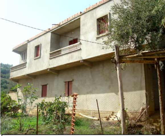
صورة رقم 84: واجهة المسكن السابق جهة الحديقة الخاصة- عين الطابية- بلدية تمالوس
