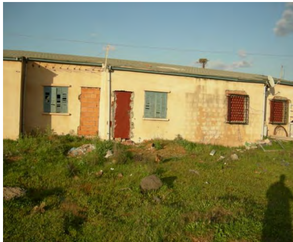
Photo VI. 23 : ouvertures de portes déplacées.
