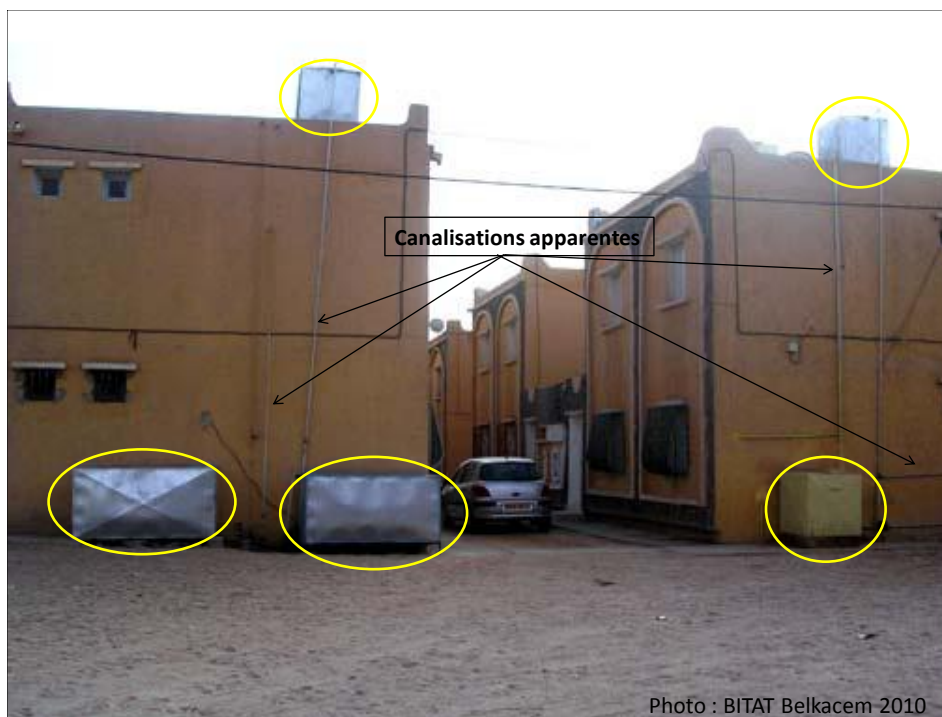
Photo n° 43 : Installation d'eau aléatoire à Tafsit
