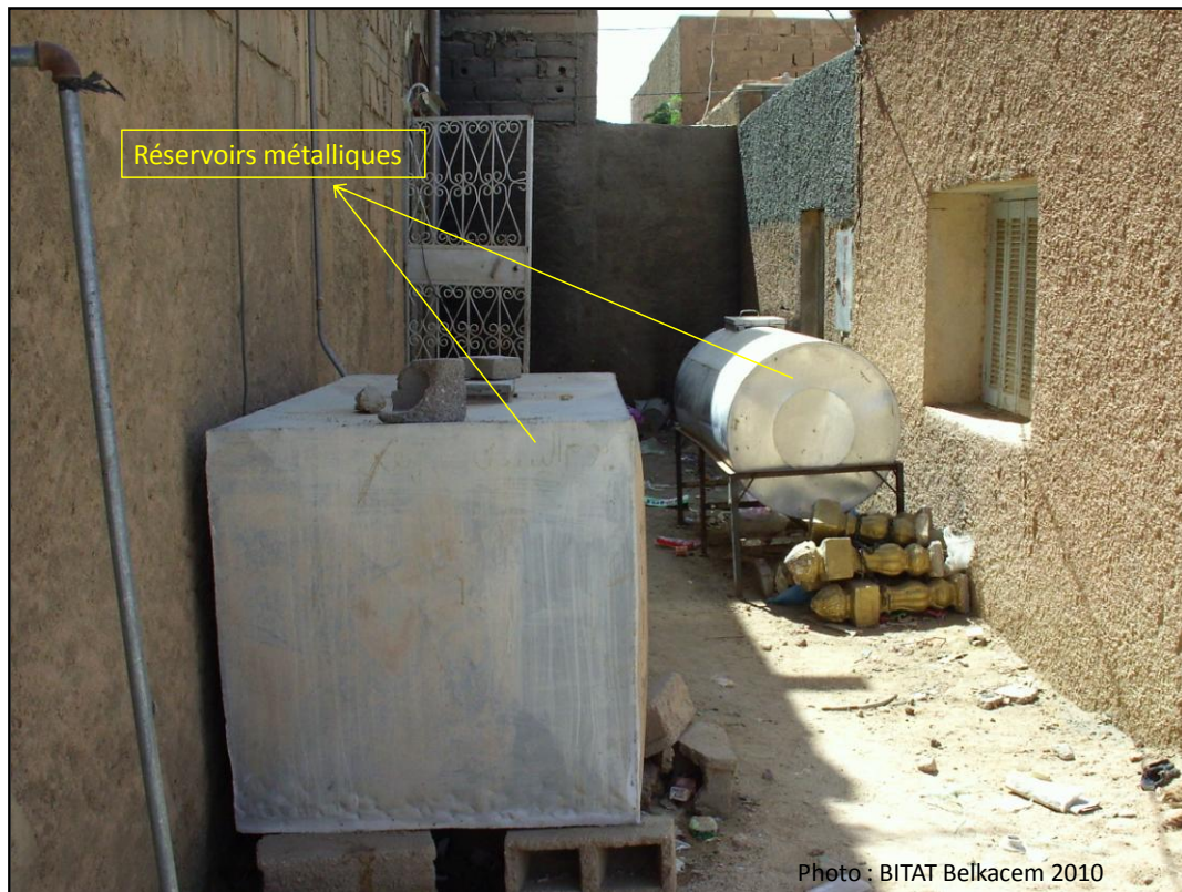
Photo n°41 : Des réservoirs installés à l'extérieur des immeubles -quartier Sersouf
