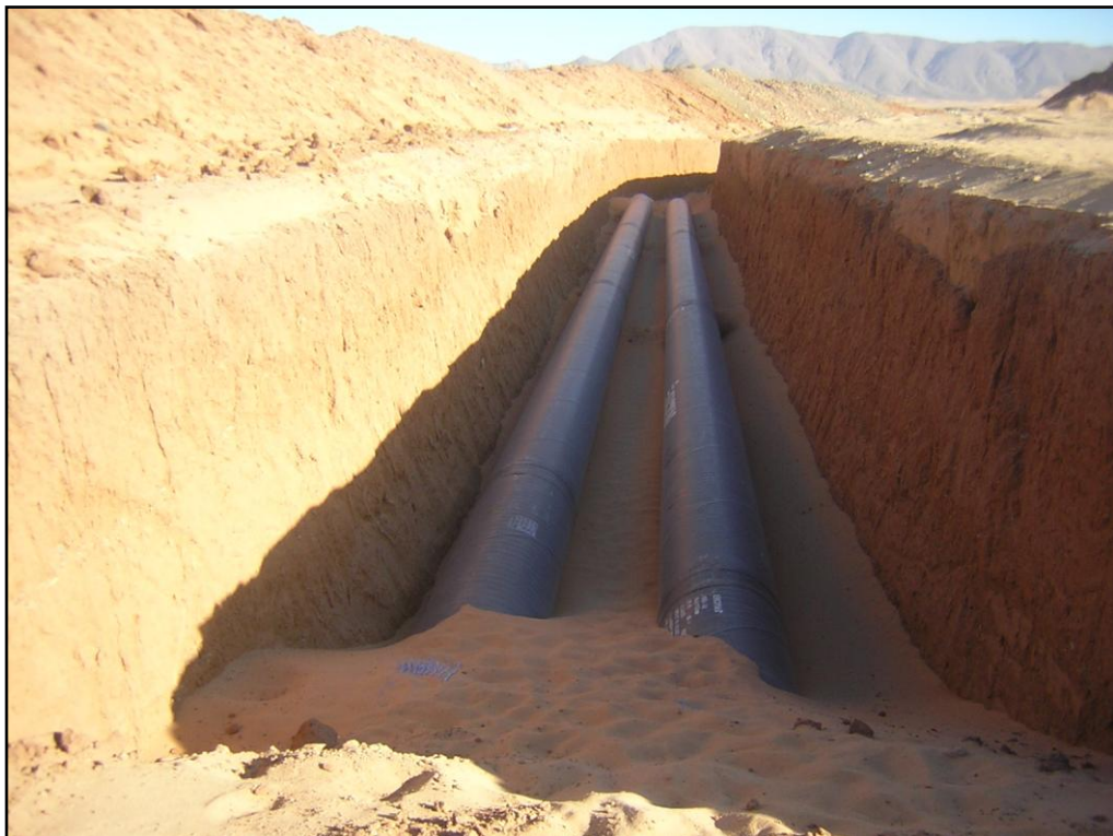
Photo n° 52 : Conduite en double linéaires
