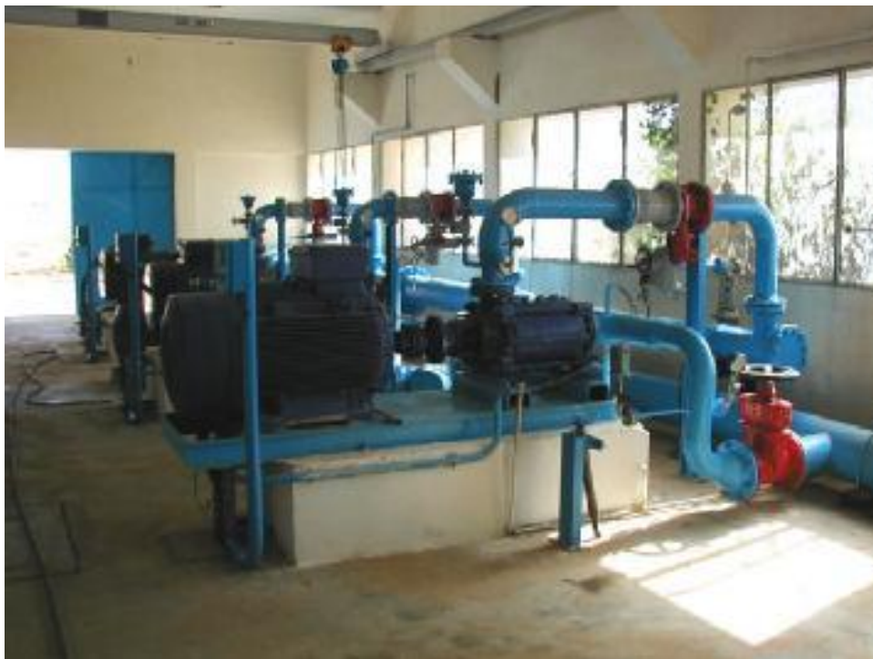
Photo n°31 Station de pompage de Tit (KSB WKF 100l/s)
