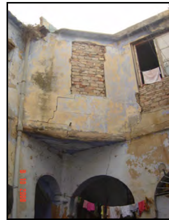
Photo 5 : vieillissement des matériaux, Souika de Constantine; Source : l'auteur 2012
