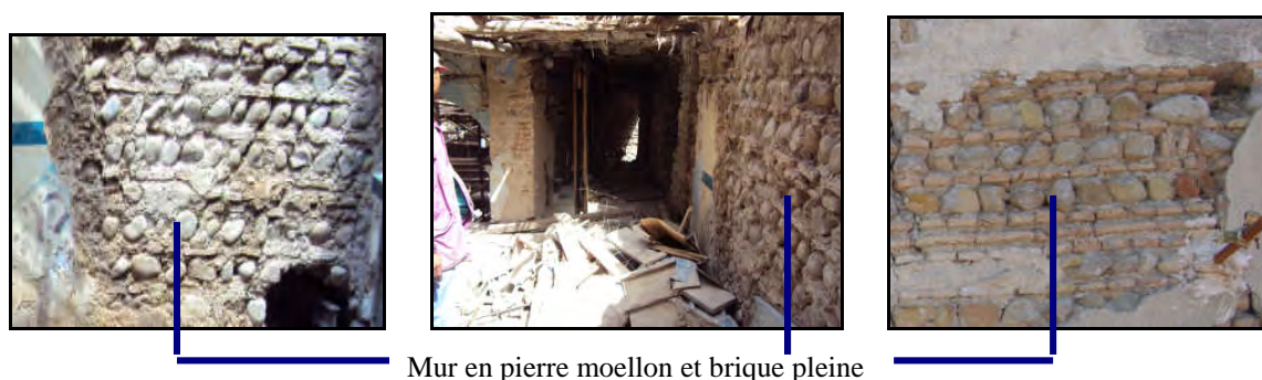
Fiche 13 : Mur construit en pierre moellon et brique pleine. Source : Chantier de réhabilitation de la maison 28. Auteur 2011.
