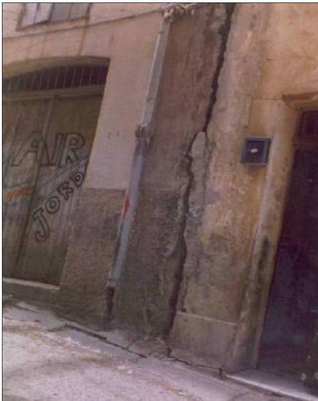
Photo n°4 : Vue d'une façade principale dégradée d'un immeuble. Site Belouizded-Kitouni (sixième partie)
