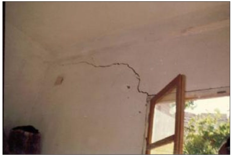
Photo n°11 : Fissuration dans les cloisons d'une construction au quatrième îlot -Site Boudrâa Salah –
