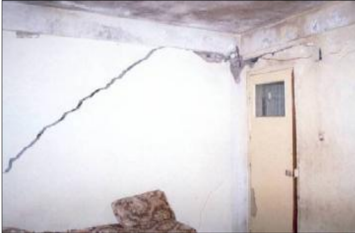
Photo n°10 : Un mur fissuré d'une construction illicite au quatrième îlot -Site Boudrâa Salah -
