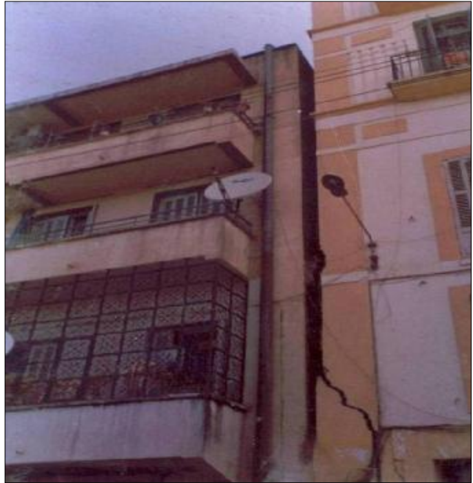
Photo n°3 : Une façade fissurée d'un immeuble. Site Belouizded-kitouni (sixième partie)
