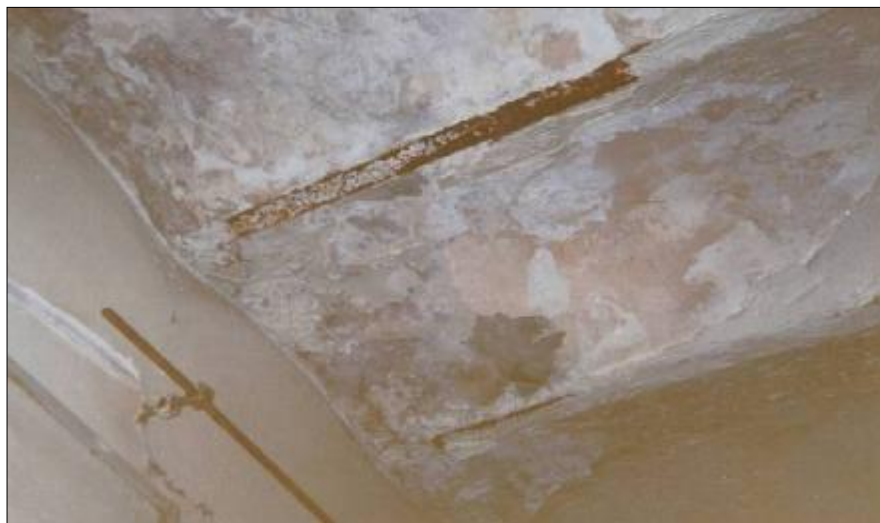
Photo n°7 Mur de clôture fissuré et dégradé d'un immeuble au site Belouizded-Kitouni (sixième partie)
