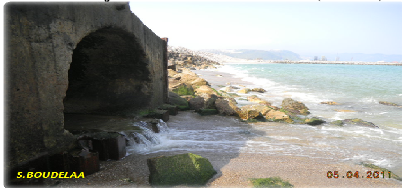
Canal de rejet du complexe GNL vers la mer via l'oued Saf-saf.
