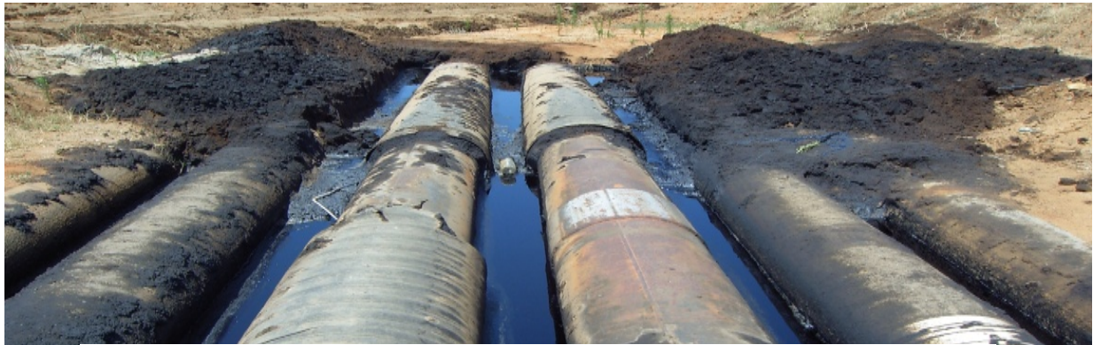
Fig 92 :Fuite du pétrole d'un oléoduc dans la ZIK.
