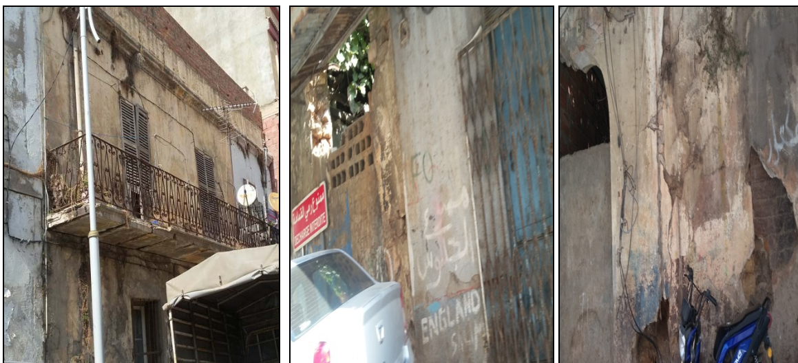
Photo.62 : Parc vétuste centre ville Jijel : Mûrs délabrés, ferrailage effrités. (rue Hocine Benchikh)
