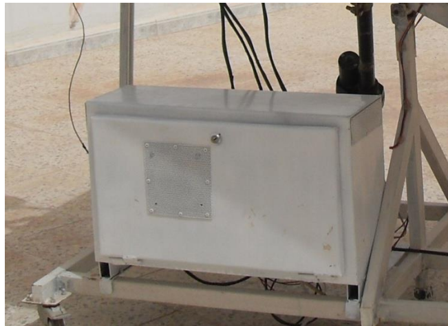
Figure IV.5. Armoire métallique de protection du circuit électrique.
