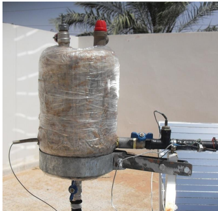
Figure II.23. Cuve de stockage de la chaleur.
