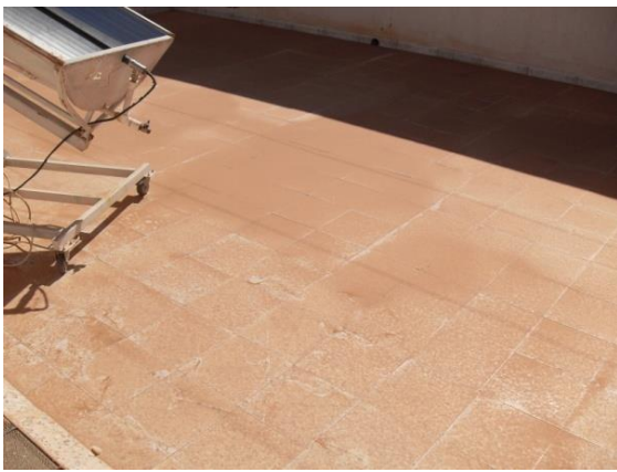
Figure IV.13. Effet du vent de sable.
