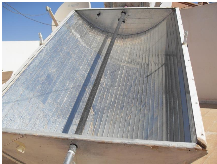
Figure IV.21. Problème de la poussière.
