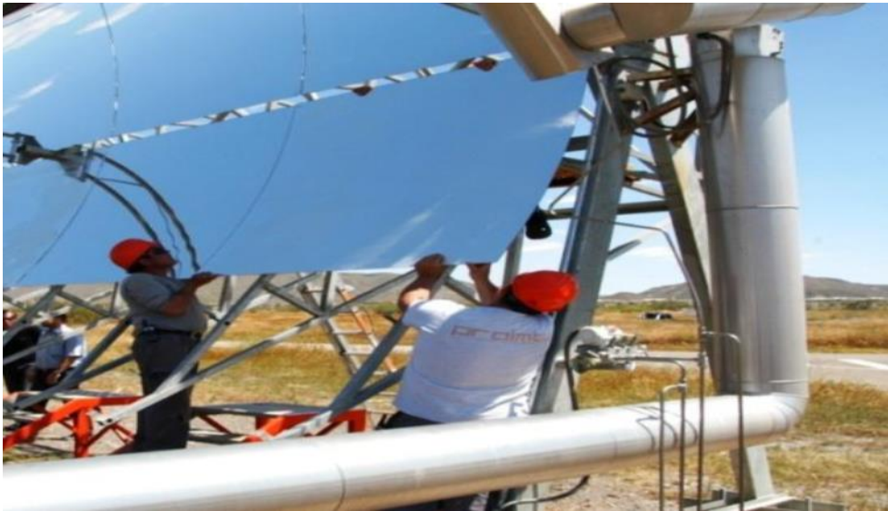
Figure II. 9. Le support d'un cylindro-parabolique enduit avec de l'argent les facettes de miroir en verre [21].
