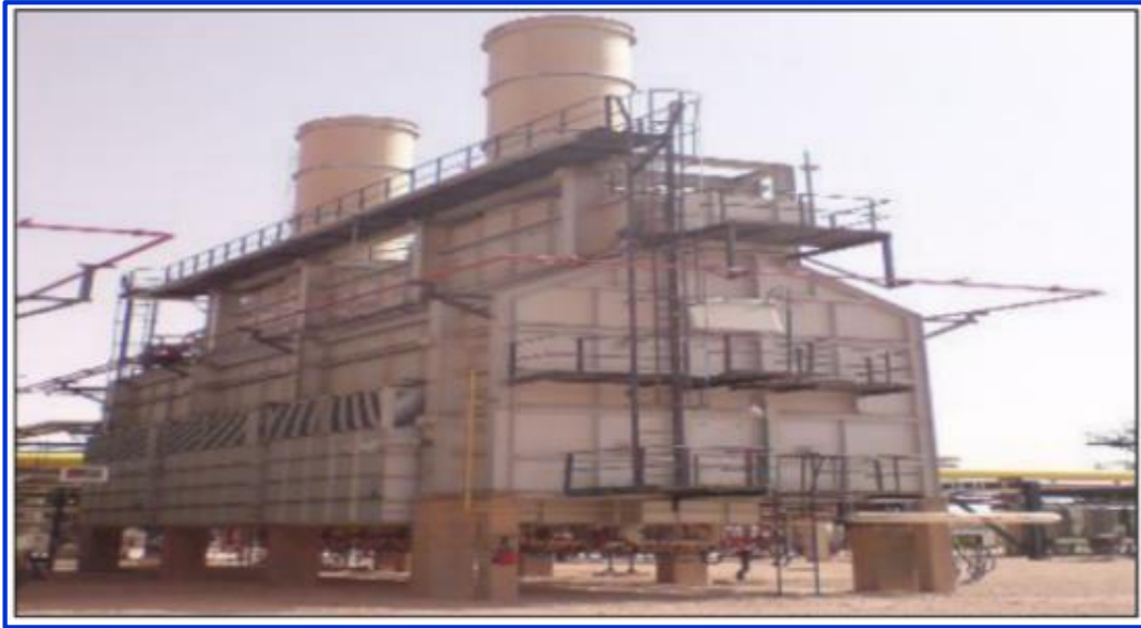
Figure 4.12 : Four Rebouilleur H-101 [SONATRACH., 2008]
