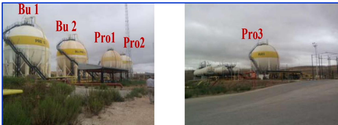
Figure 3.20 : Sphères de stockage GPL (Hellas et al., 2018b)
