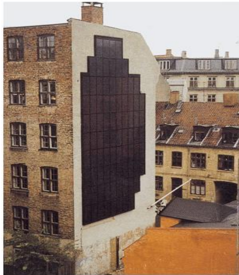
Figure IV.22e. Intégration en façade
