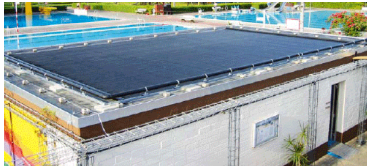
Figure IV.8. Piscine chauffée par l'énergie solaire [233]
