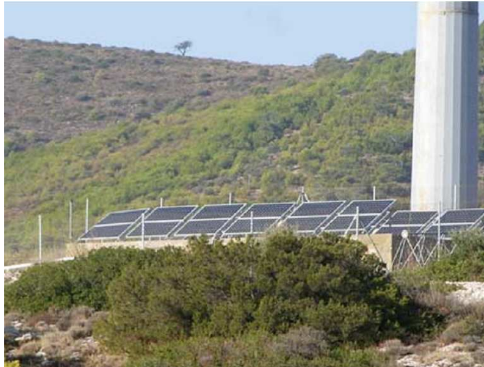
Figure IV.6 : Modules PV de 4 kWp
