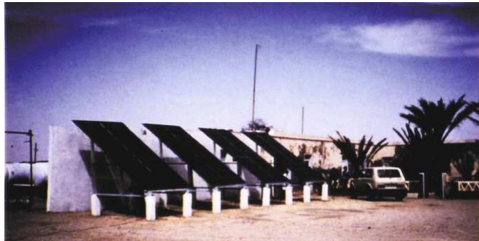
(a) Générateur photovoltaïque 2,59 kW crête
