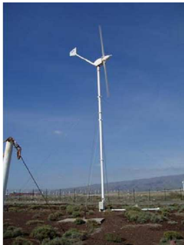
Figure IV.4 : Turbine éolienne de Pozo Izquierdo
