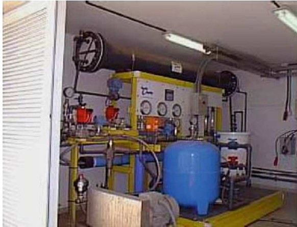
Figure IV.3 : Unité d'osmose inverse de Pozo Izquierdo
