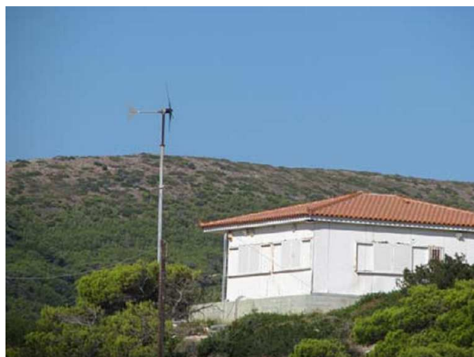
Figure IV.5 : Turbine éolienne de 900 W
