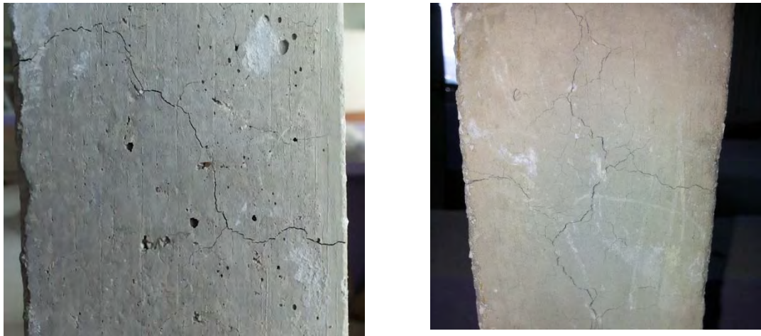
Figure 5.5. Fissurations dans les BOFM
