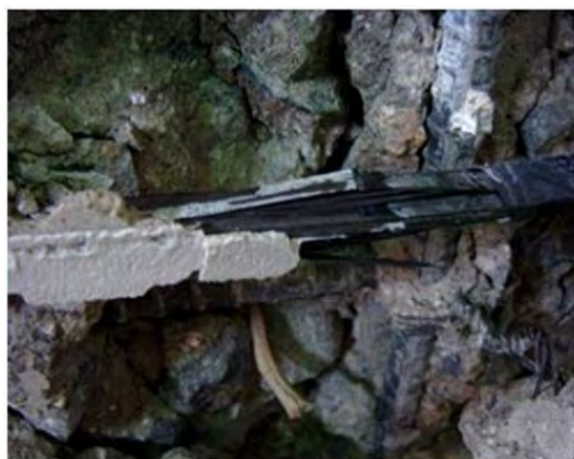
Figure III-6 : Endommagement du PRFC après l'essai.
