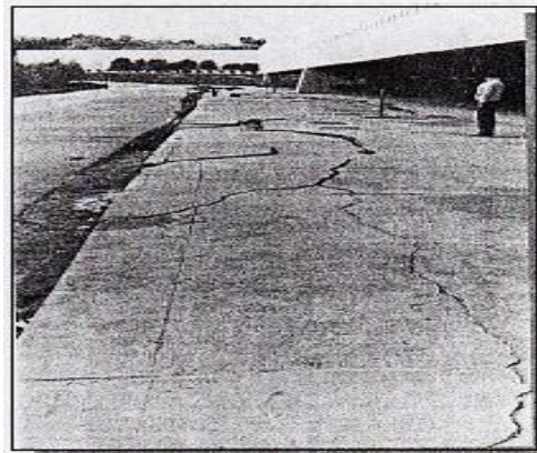
Fig3.3 : Façade Est du bloc des classes affaissement de la chaussée
