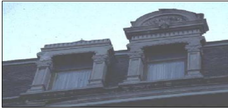
Figure 13 : Le chute d'un élément décoratif lors d'un séisme .
