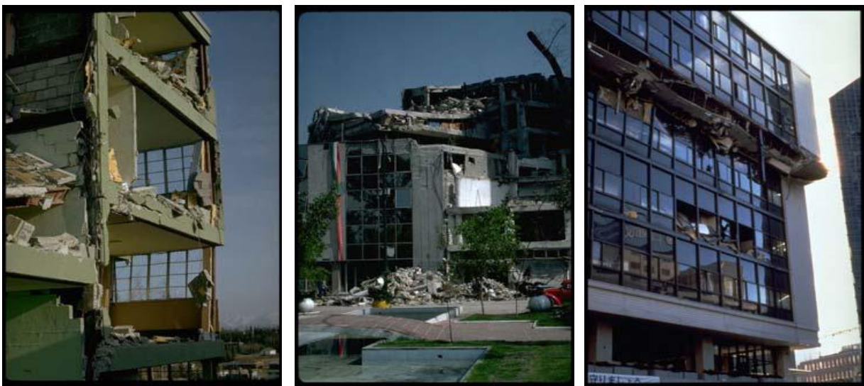
Figure 3: Désolidarisation des façades, destruction des étages supérieurs, intermédiaires ou inférieurs
