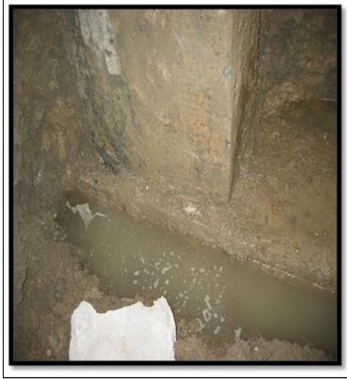
ü Venues d'eau au pied des fondations.
