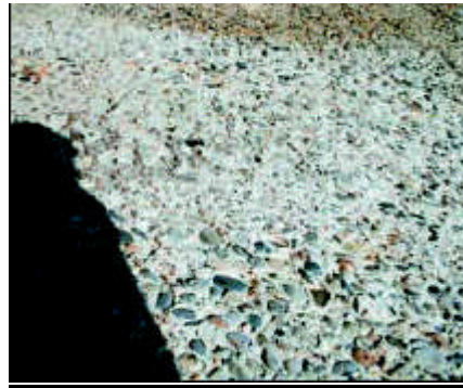
Figure 2.1 : Aspect d'une surface en béton ayant été soumise au phénomène de lixiviation.
