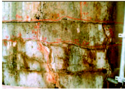
Figure 1.13 : Pile de pont affectée par une réaction de gonflement interne due à la formation d'ettringite différée.
