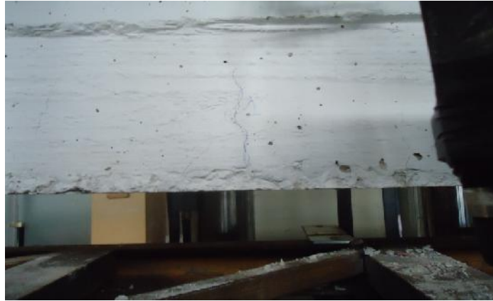
Figure IV.24 : Apparition des premières fissures de la poutre P2
