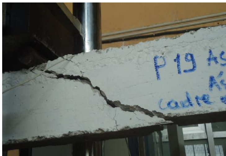
Figure IV.28 : Rupture par cisaillement de la poutre 19
