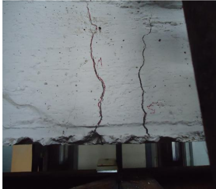
Figure IV.20 : Propagation des fissures pour la poutre P1
