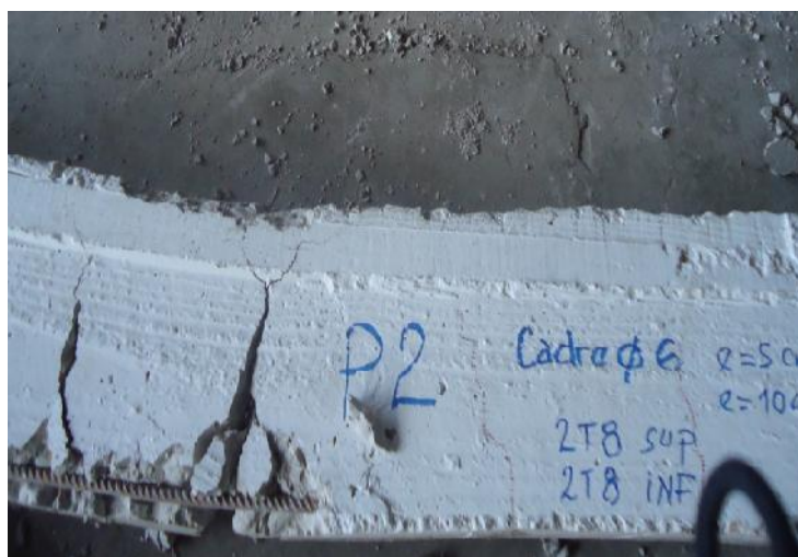
Figure IV.26 : Endommagement de la poutre P2
