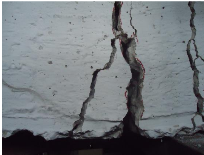
Figure IV.21: Endommagement de la poutre
