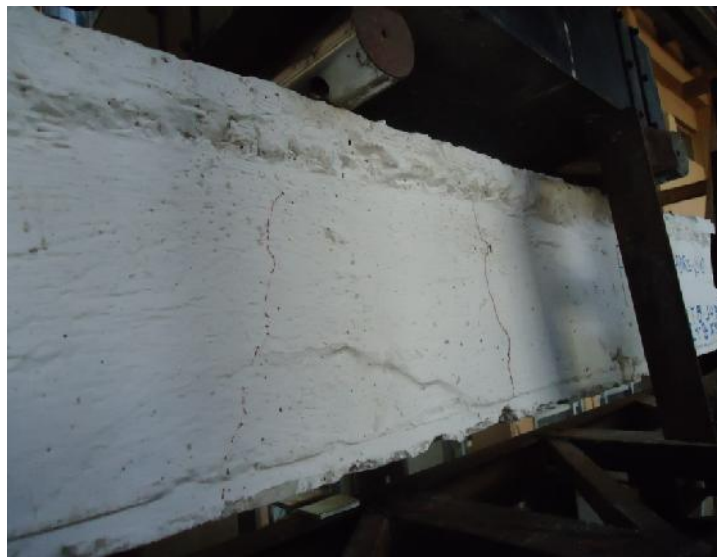
Figure IV.19 : Apparition des premières fissures pour la poutre P1
