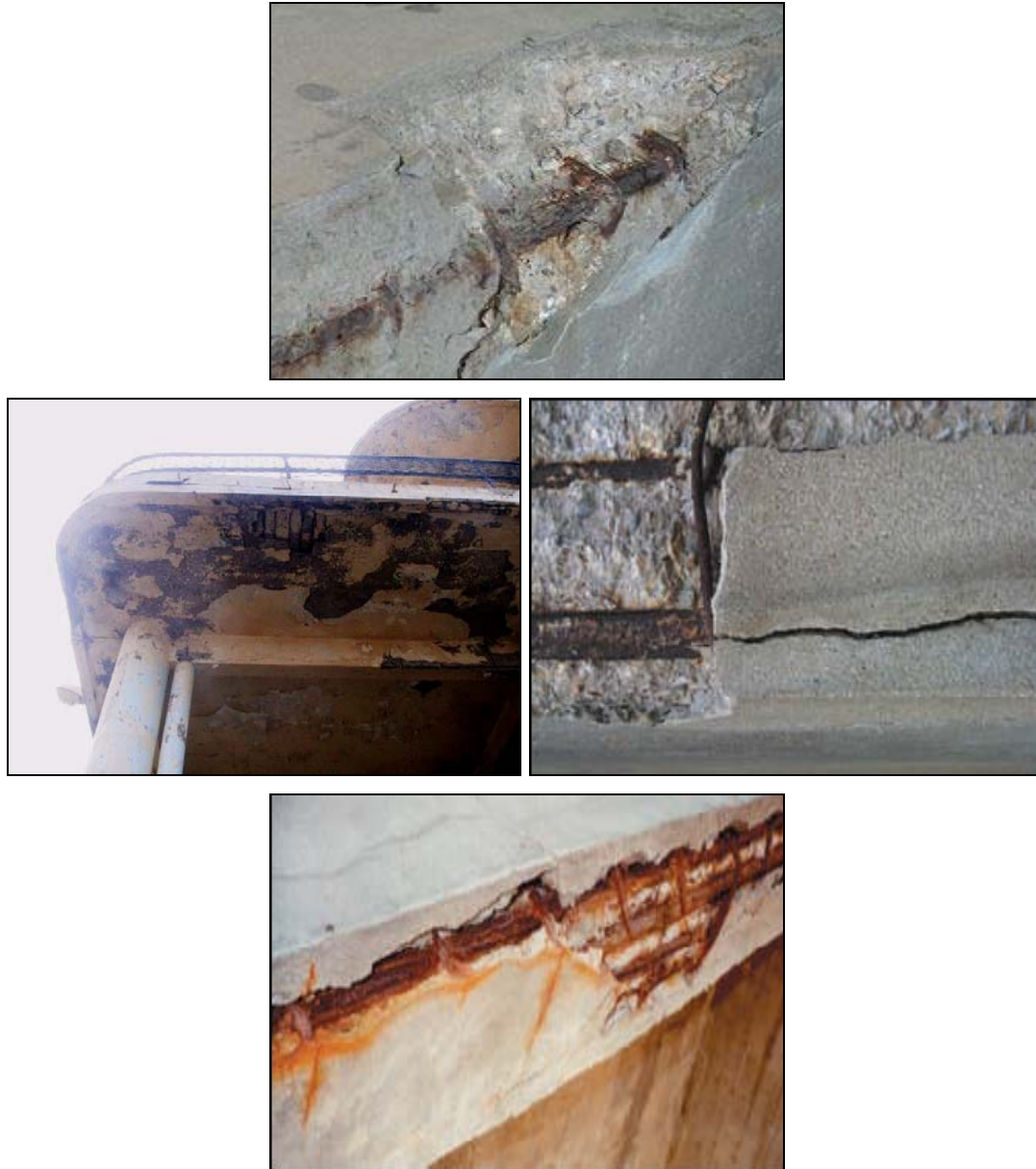
Figure 3.1: Exemples de corrosion par carbonatation
