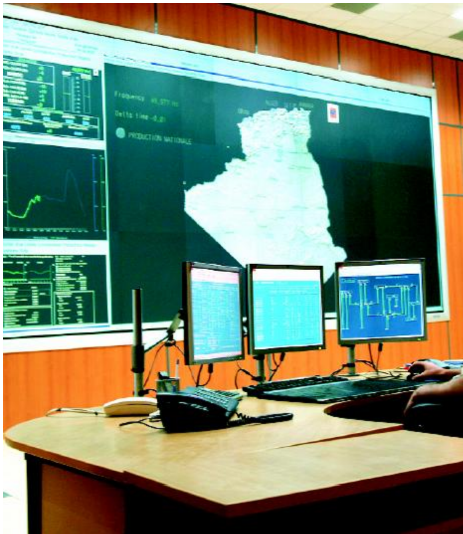
Figure. III.8 La salle de contrôle du dispatching national, O.S SONELGAZ, Immeuble des 500 bureaux-Gué de Constantine –Alger
