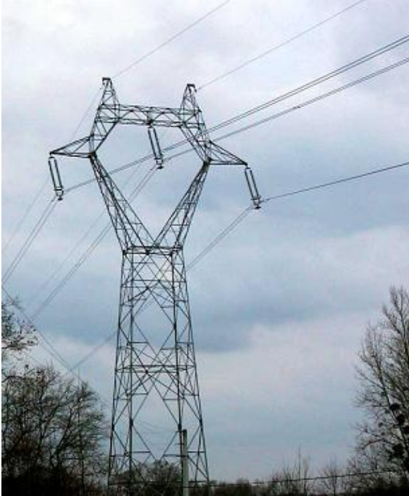
Ligne HTB monoterne en faisceau
