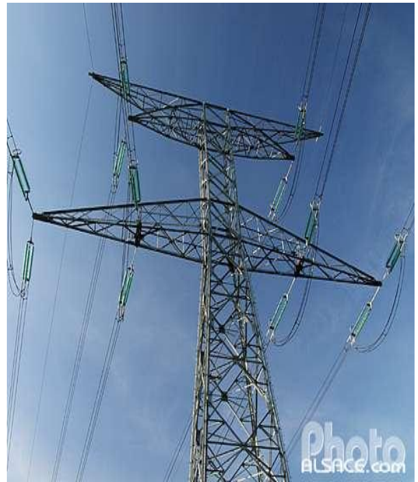
Ligne HTB biterne en faisceau
