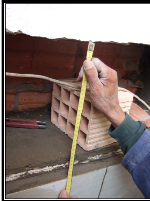
Figure 4.88 : Ouverture de la partie de soufflage sur une hauteur de 30 cm
