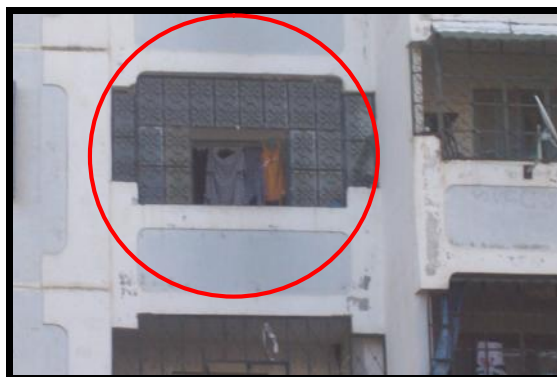
Figure 5.17 Fermeture de la loggia par du verre monté sur une structure métallique.
