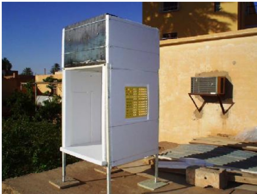
Photo V. 3 : Cellule en période de réalisation La fixation d'un grillage en matière plastique, à mailles fines, limite la transmission du rayonnement solaire
