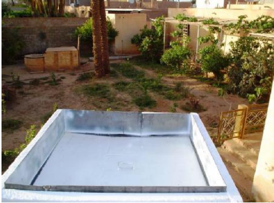
Photo V. 10 : Vue montrant la toiture en état de fermeture avec le système de refroidissement
