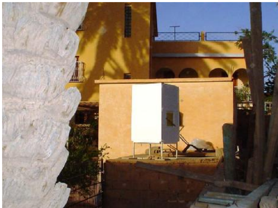
Photo V. 7 : Vue montrant la cellule finalisée
