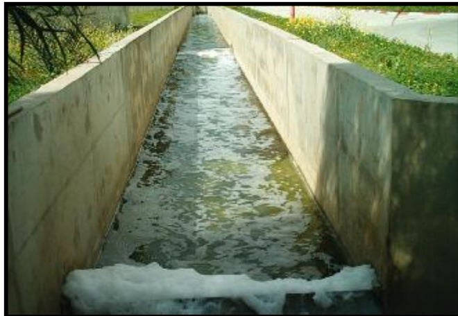
Photo n°7 : Canal des rejets de la station d'épuration IBN ZIAD
