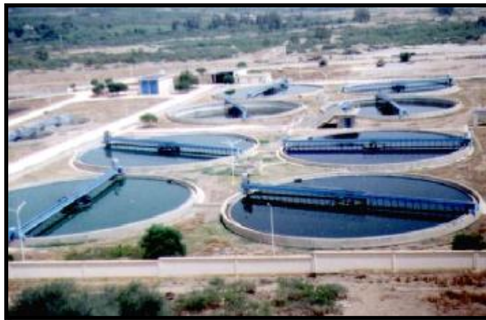
Photo n° 6 : Bassins de décantation secondaire
