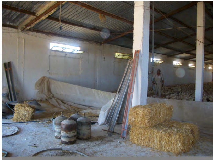
Figure 24 : Bâtiment sans sas
