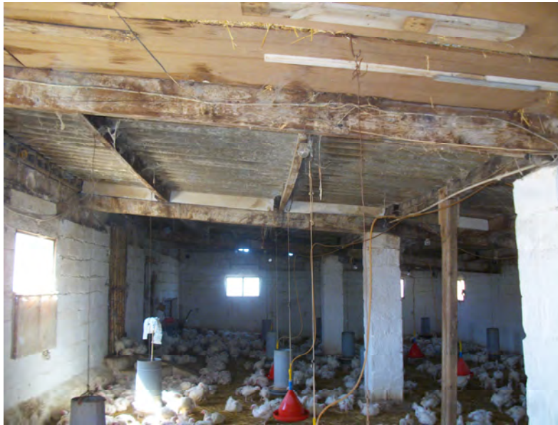
Figure 5 : Murs et plafonds présentant des anfractuosités
