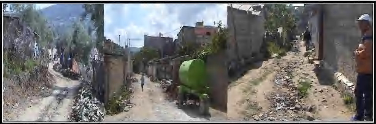
صورة رقم 58: تعكس حالة الطرقات الداخلية مركز جبل مكسن التقطت من طرف الباحثة في فيفري 2017.
