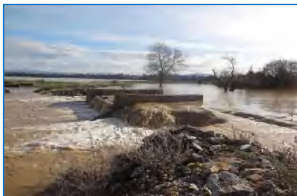
Photo 39: Digue 4 endommagée au niveau de la jonction de la digue avec l'ouvrage annexe équipée d'un clapet anti-retour (Oued Lahmar) (DRE, 2015).
