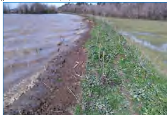
Photo 37: Digue 5 : Erosion différentielle du corps de la digue sur un linéaire de 03 Km. (DRE, 2015).
