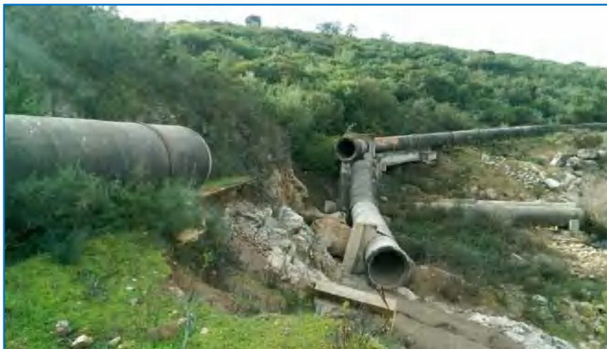
Photo 5. Destruction d'un tronçon de la conduite d'irrigation (Affoun, 20 novembre 2018).
