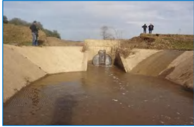
Photo 35: Dysfonctionnement du Clapet à Ogbet Chair passage sous-digue 6 d'El Tarf. (DRE, 2015).
