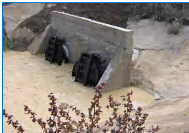
Photo 20: Passage sous-digue équipé de deux clapets anti-retour (digue 6). (ONID El Tarf, 2011)
