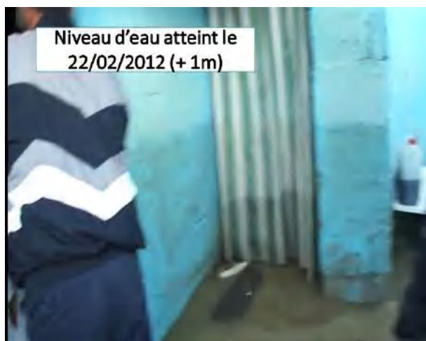
Photo 42: Niveau d'eau atteint le premier jour de l'inondation du 22 février 2012 (habitation dans Bouhllala commune de Ben M'hidi). (Wilaya d'El Tarf, 26 février 2012)
