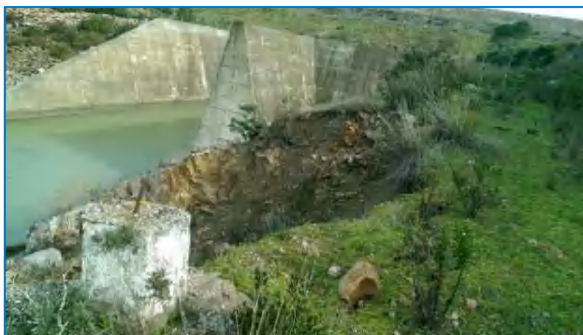
Photo 6 : Dégradation du talus à l'exutoire du bassin de dissipation sur la rive gauche (Affoun, 20 novembre 2018)
