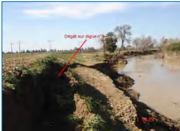
Photo 33: Sapement de la digue 5 côté Oued Kébir (ONID, 5 mars 2012)
