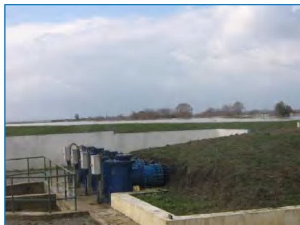
Photo 24: Station de pompage équipée de 4 pompes. (ONID El Tarf, 2011).
