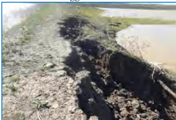
Photo 36: Digue 5 : Dégradation au niveau de la jonction de la digue avec un ouvrage annexe ; passage sous-digue avec clapet (DRE, 2015).
