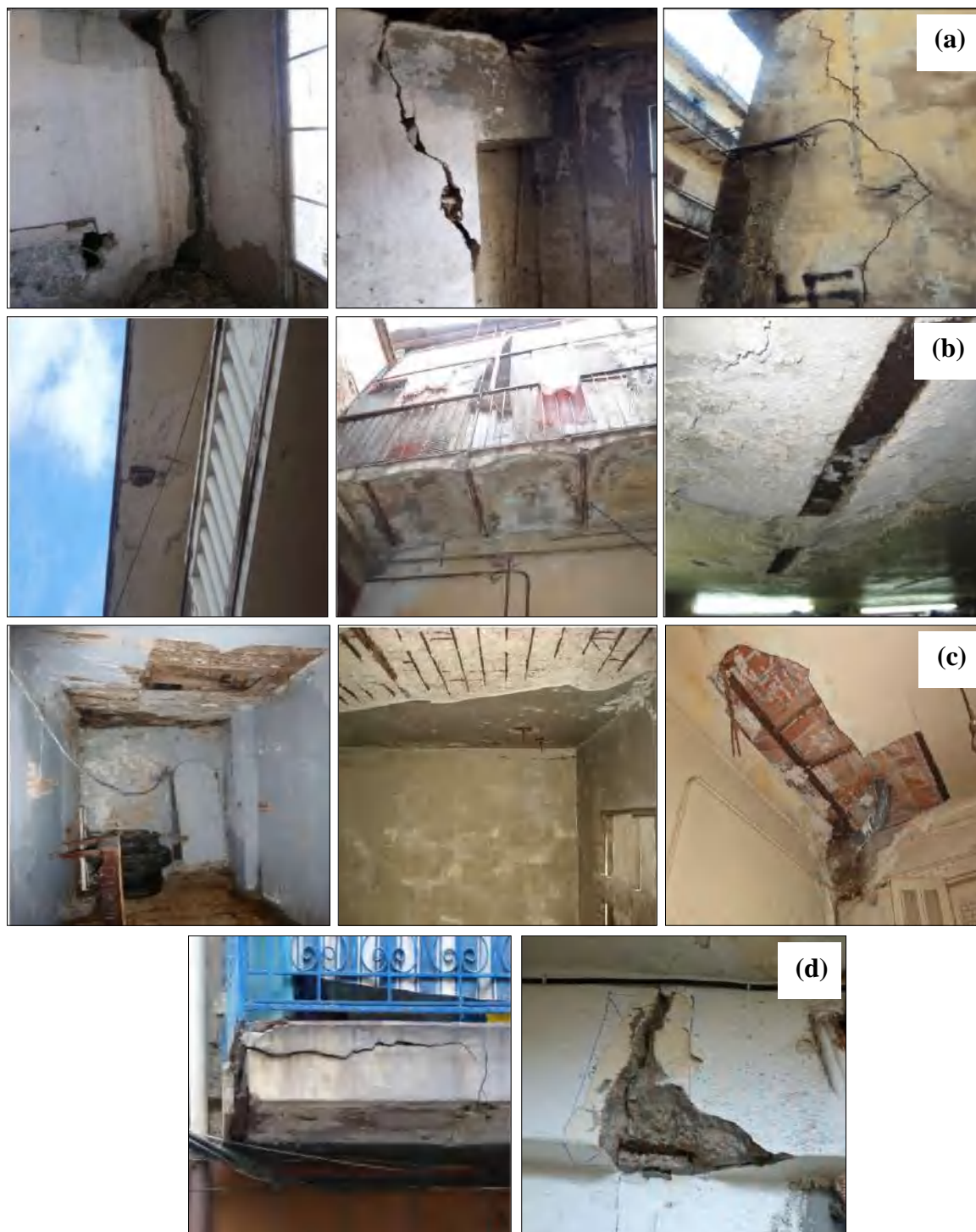
Figure 1.27 : Photos sur les différentes pathologies et dégradations à Skikda : a) Fissuration verticale dans la cloison, fissurations obliques au niveau des murs porteurs et fissuration verticale au niveau du mur porteur ; b) Corrosion de solive, corrosion en voûtes et corrosion des poutrelles métalliques ; c) Effondrement partiel des planchers (en bois, en béton armé et en voûtes) ; d) dégradation des balcons (CTC, 2012, Groupement CTC et AQUIDOS, 2016).
