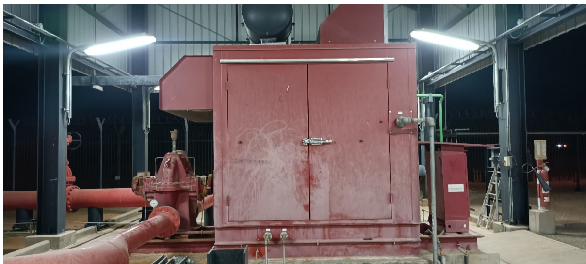
Figure IV. 15: Pompe diesel de la pomperie
