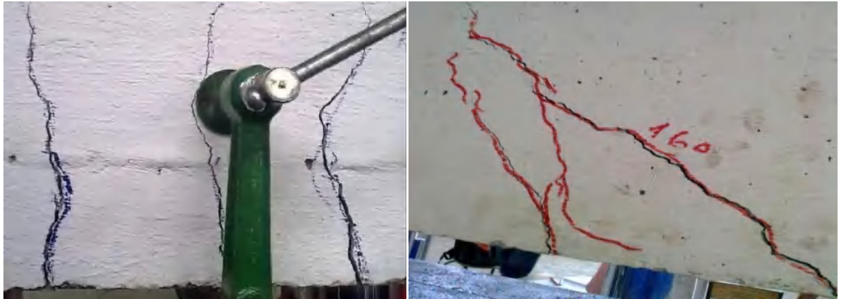
Figure (5.13) :Les fissures au milieu. Figure (5.14) :Les fissures au niveau des appuis.
