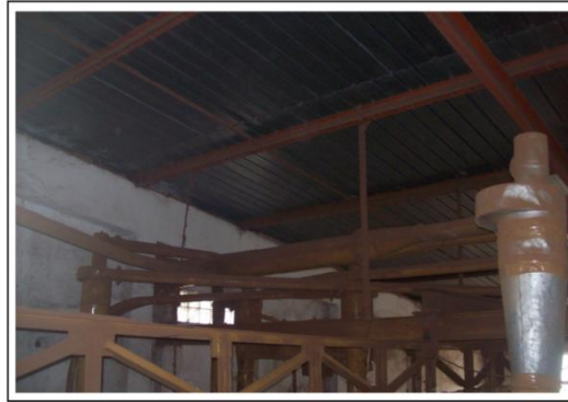
Photo 03: Corrosion des profils des poutres de l'usine de liège d'Ouled Salah- Jijel.
