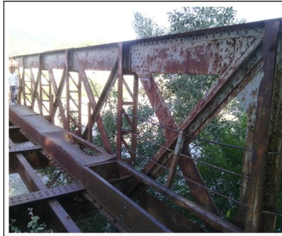
Photo 01: Corrosion d'un pont métallique de Milia-Jijel.
