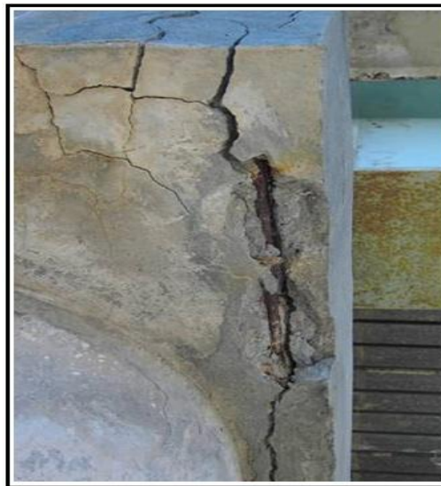
Photo 04: Corrosion des armatures du béton et l'éclatement d'enrobage du béton d'un pont mixte de la ville de Jijel.
