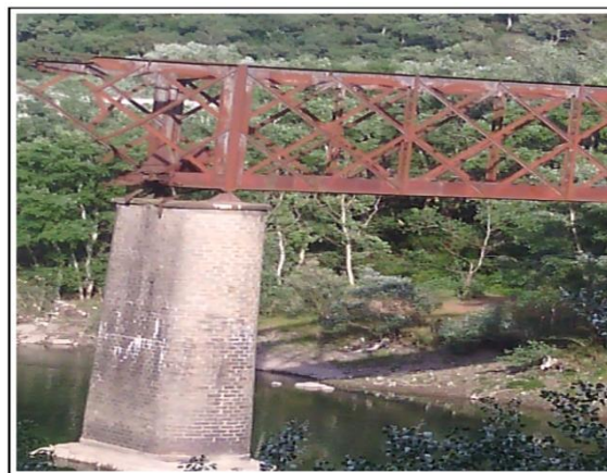
Photo 02: Corrosion et destruction partielle de passerelle métallique à el Ancer-Jijel.
