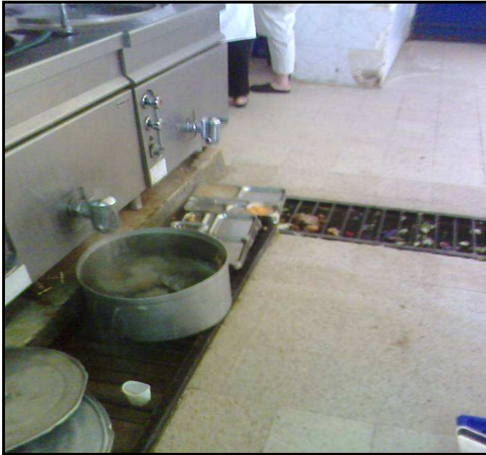
Figure 14 Débris de denrées sur les les filtres d'évacuation
